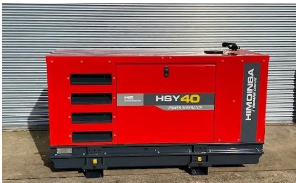
Agregat prądotwórczy w Lenarczycach
